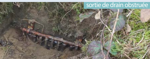
sortie de drain obstruée
